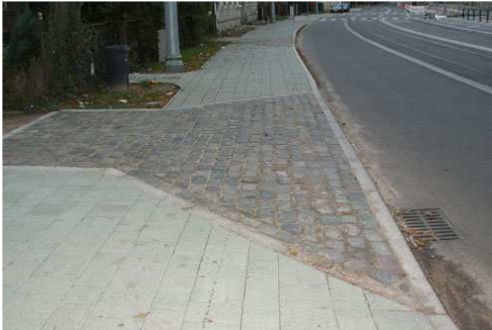
Fot. nr 1. Jeden z wielu wyjazdów na tej drodze. Zastosowana nawierzchnia mocno utrudnia poruszanie się osobom niepełnosprawnym na wózkach inwalidzkich.
