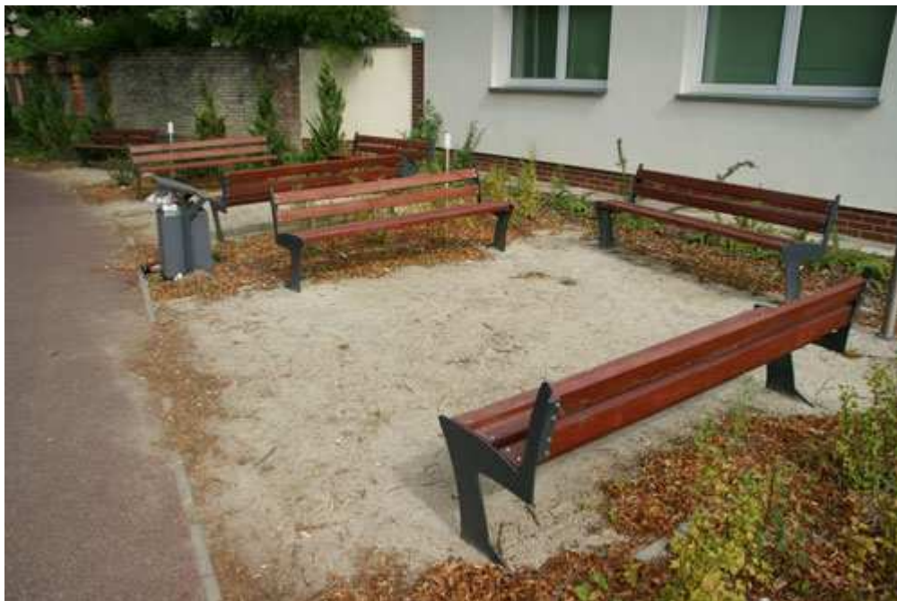
Fot. nr 6. Nawierzchnia przy ławkach utrudnia dojazd do nich.
